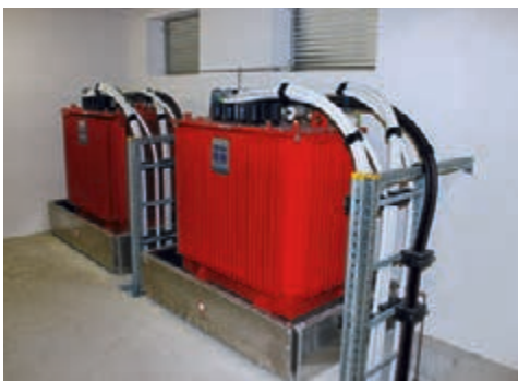
Transformatorstation Schule Untersiggenthal.
