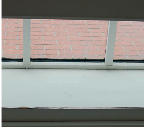
Undichte Fenster in der Aula.
